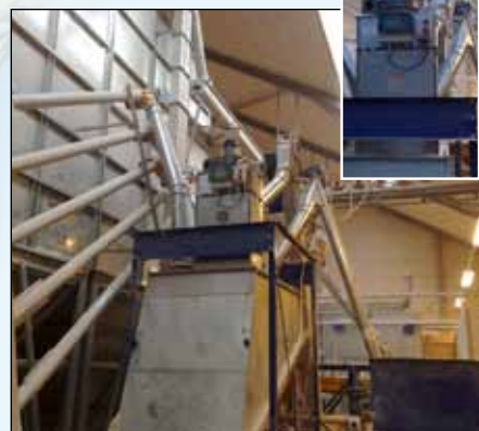
HR-m-2 monteret direkte på toppen af foderblandingsanlæg.
